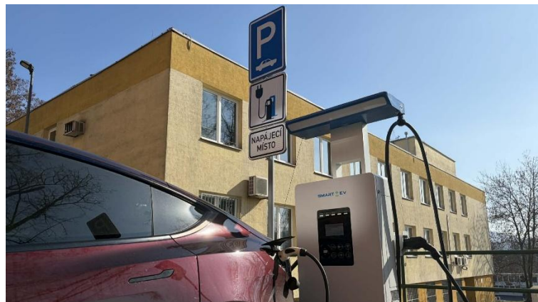
Jediná dobíjecí stanice v areálu univerzity u budovy FSI.
