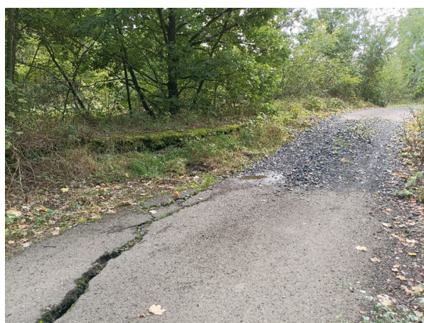
Obrázek 5. Trhání vozovky na svahu nad Stříbrným rybníkem jako ukázka svahových pohybů terénu nad bývalým povrchovým dolem. Foto T. Matys Grygar.
